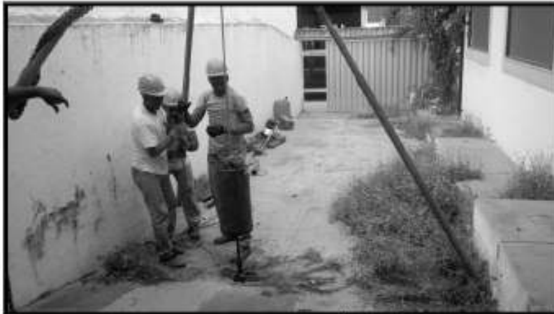
FOTO 01 – Equipe executando sondagem à percussão (SPT) no terreno para reforma do fórum em Aracati, Ceará
