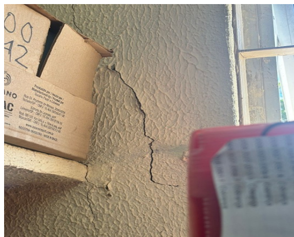
Foto 2 – Parede da sala de arquivo
