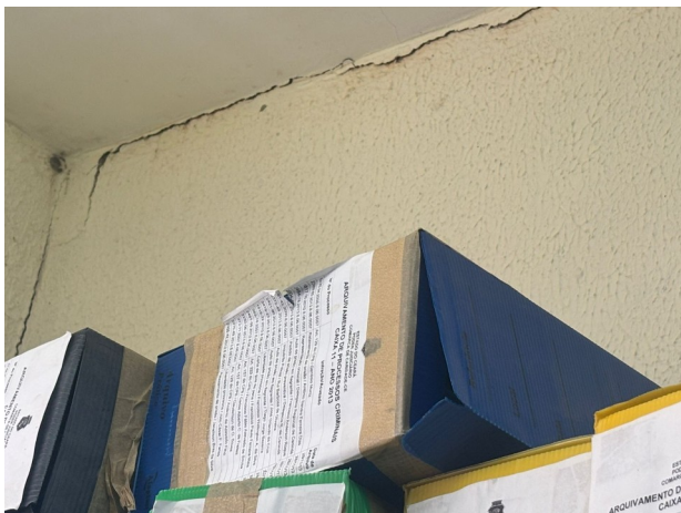
Foto 1 – Parede da sala de arquivo
