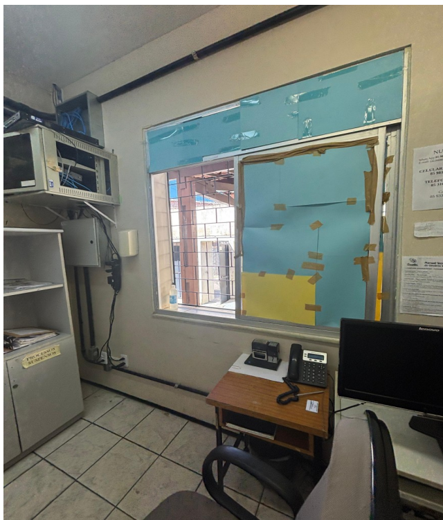
Foto 3 – Sala de servidores
