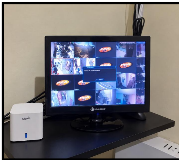
Sistema de videomonitoramento registrando a rotina do Centro
