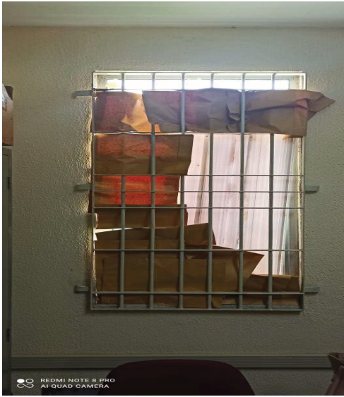
Figura 4: Janela com vidro quebrado
