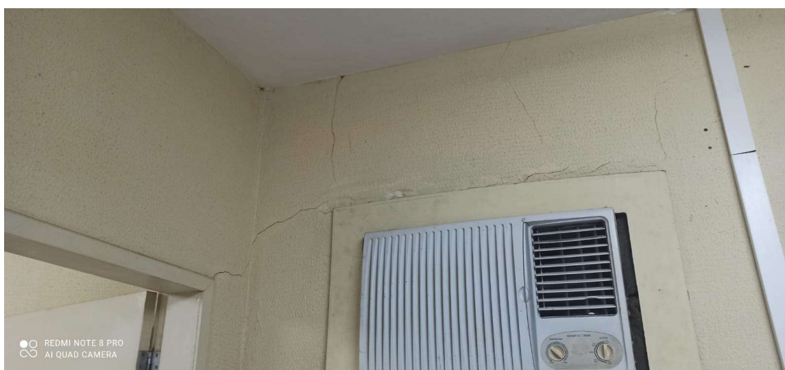
Figura 4: Imagem ampliada da rachadura
