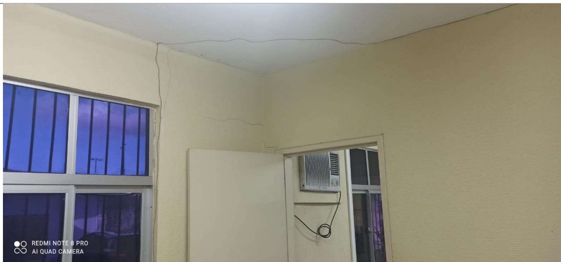
Figura 3: Imagem da sala com cupins e rachaduras
