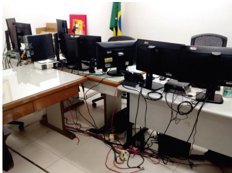
Foto 1 – Visão geral do emaranhado de cabos
